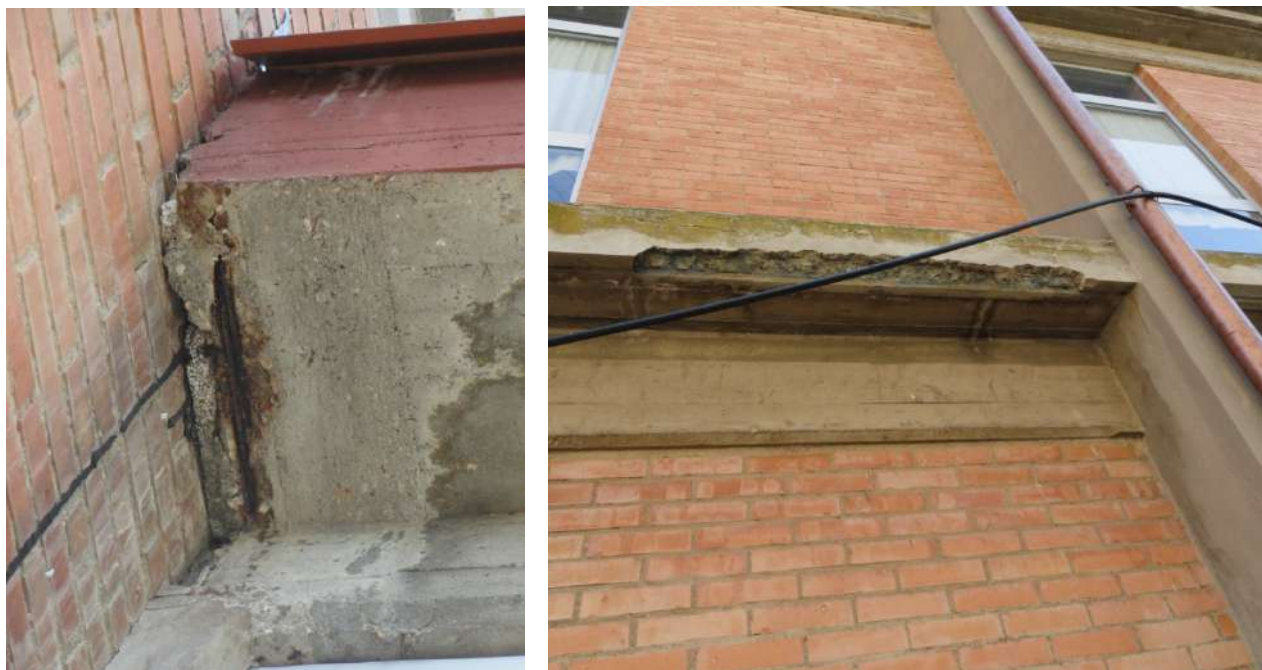
Figura: Dettaglio elementi in c.a. con armature interessate da corrosione
